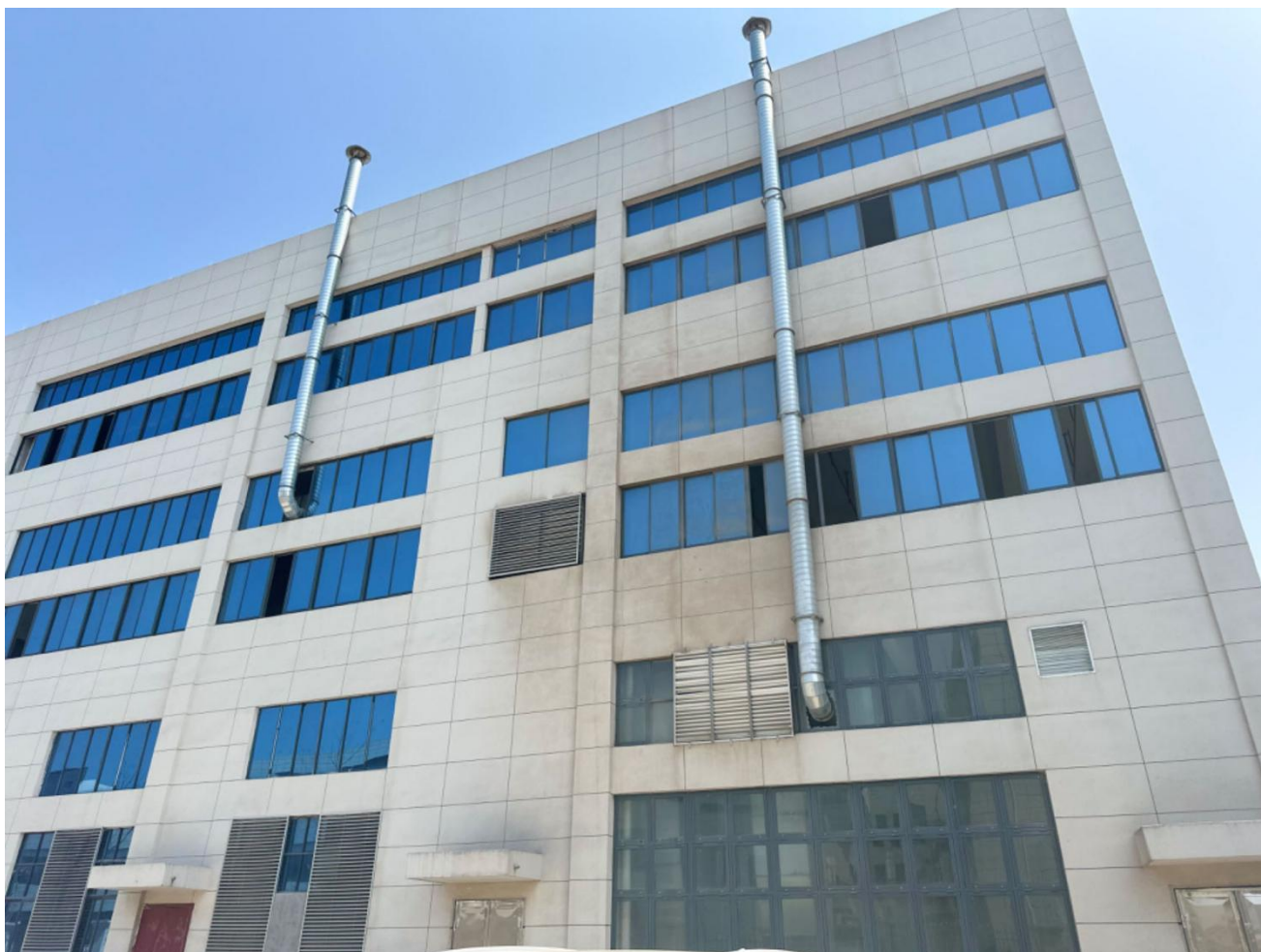
图4.1-14 DA001废气治理设施、排气筒
