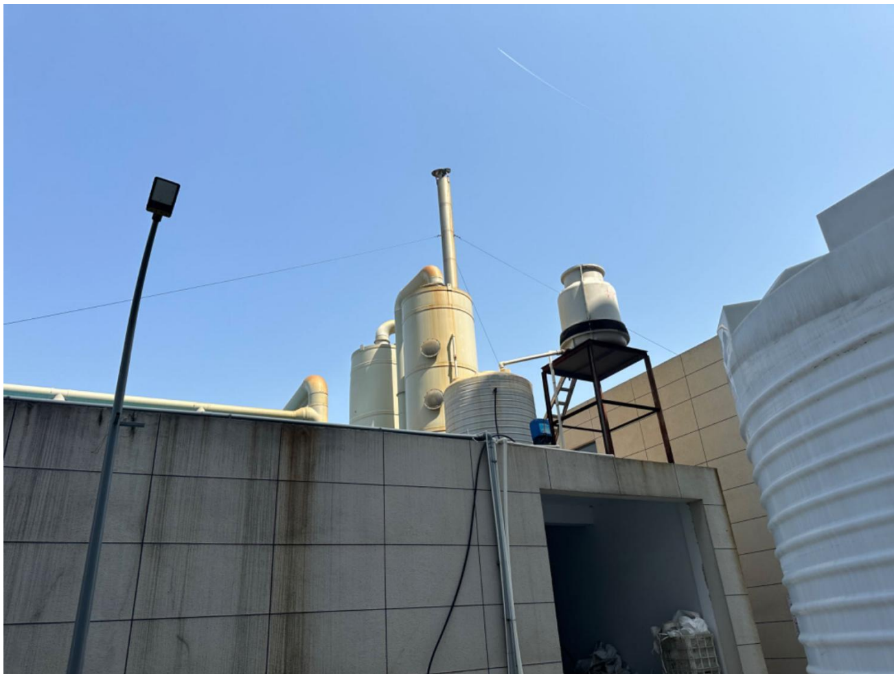
图4.1-16 DA003废气治理设施、排气筒
