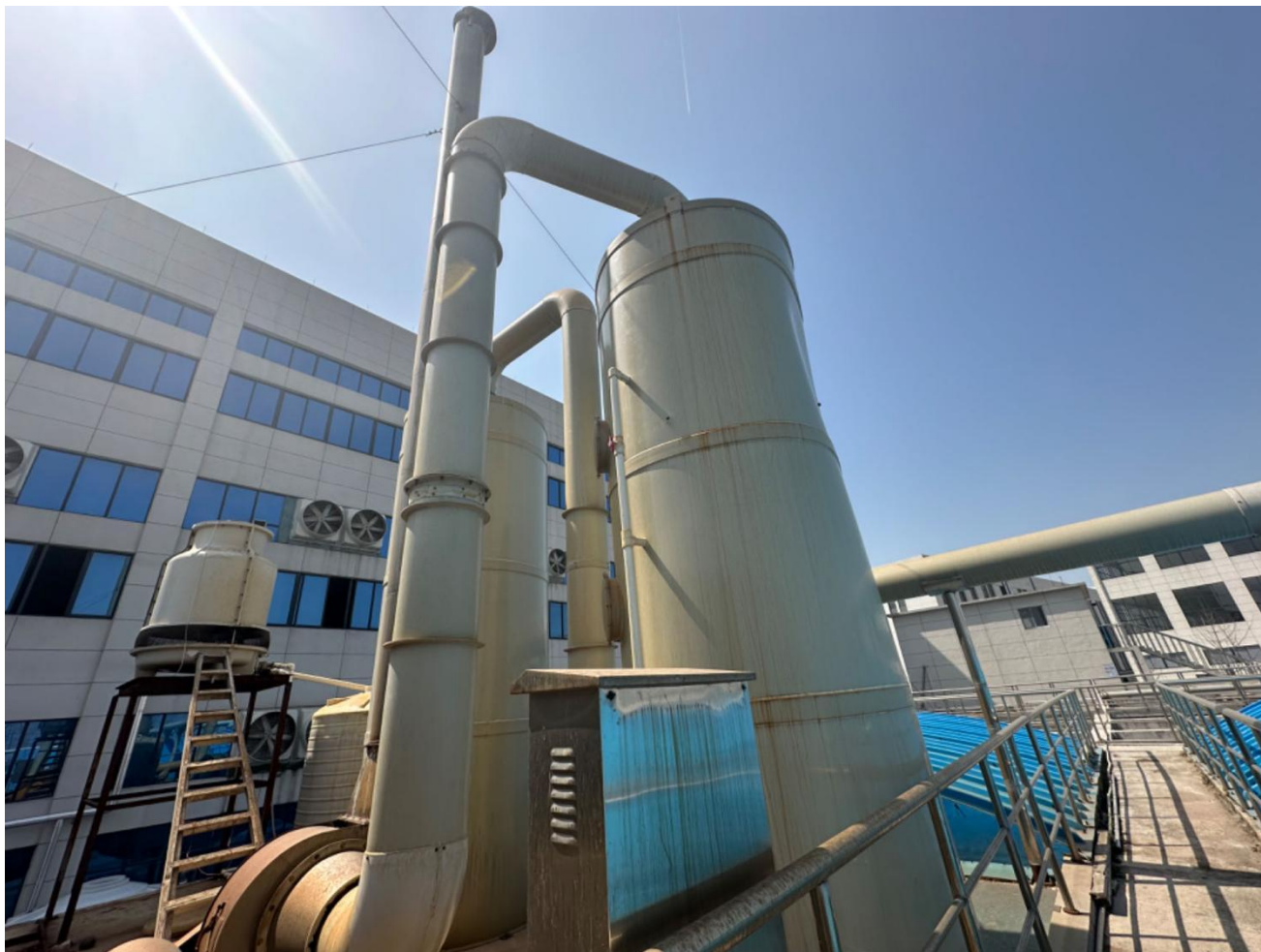
图4.1-6 污水废气排放口
