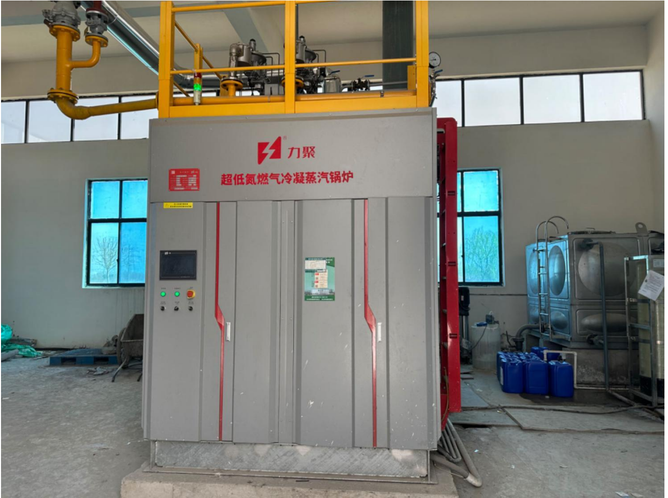
图4.1-15 DA002废气治理设施、排气筒
