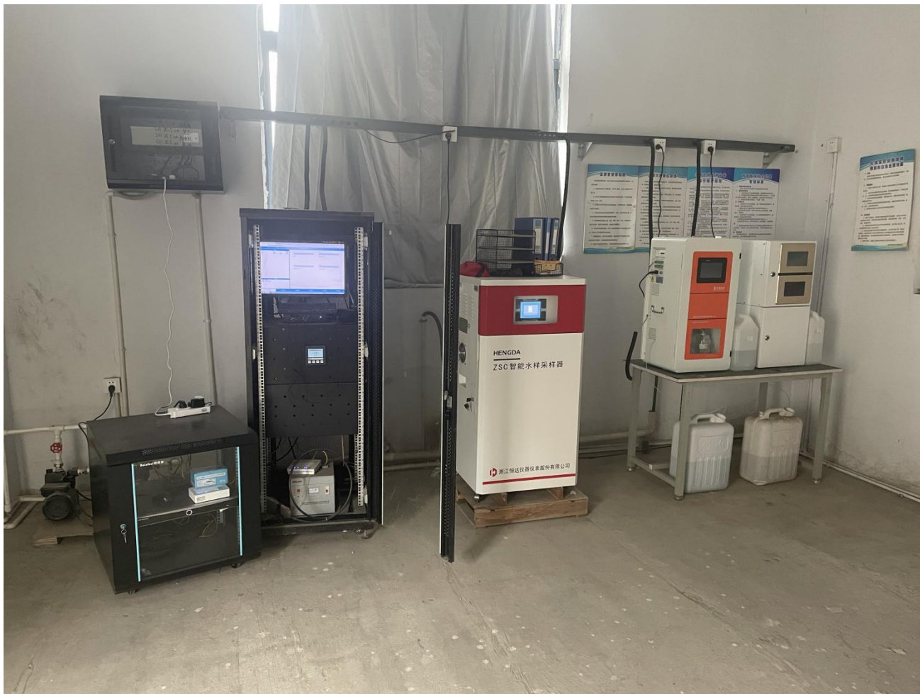
图4.1-9 废水在线监测设施
